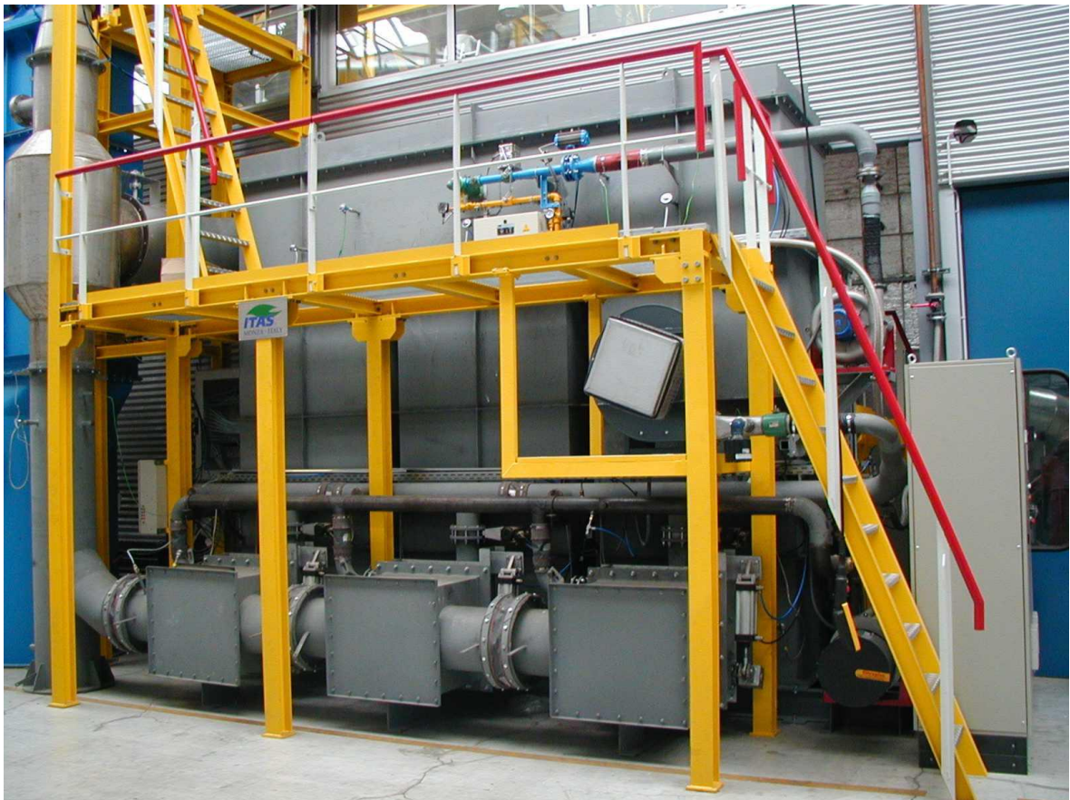
Abbildung 17: RNV-Anlage im Technikum des CUTEC Institutes
