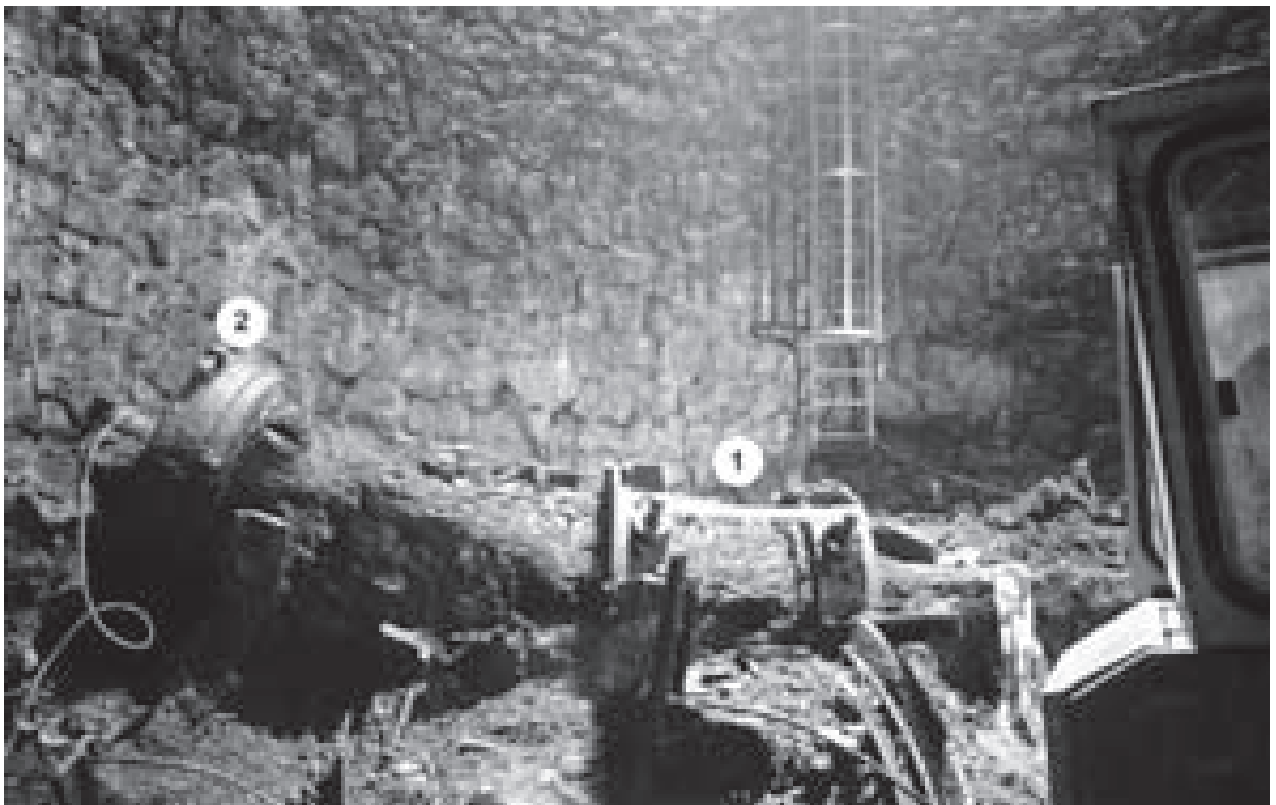
Abb. 112: Runde Radstube. Reste des eisernen Seilkörbes auf der Welle während der Bergung.
