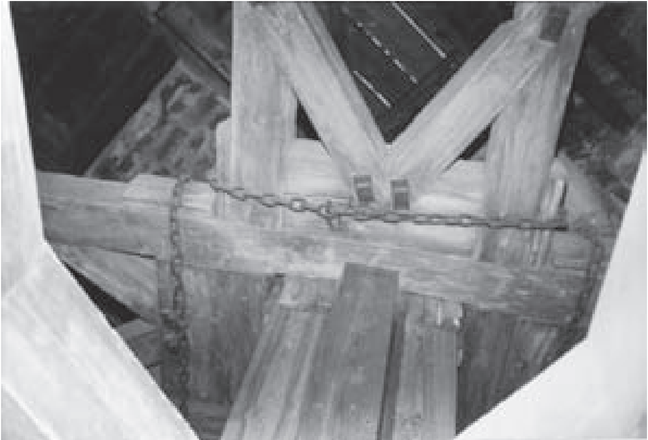
Abb. 107: Kehrrad der Grube Samson in Sankt Andreasberg. Verspannung der Arme mit Ketten.
