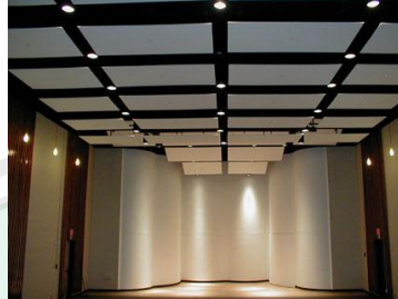
Gambar 2.44 Panel yang digantung bebas di plafon
