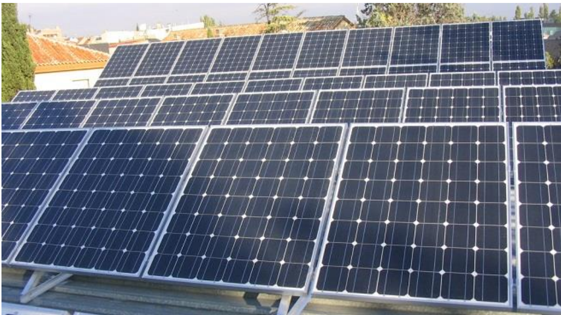
Ilustración 8: Grupo de paneles fotovoltaicos.
