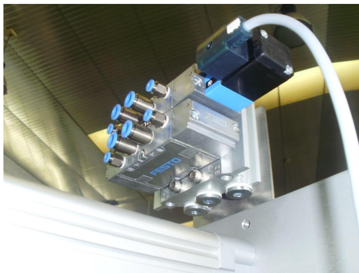
Figura 94. Conjunto de válvulas y racores.
