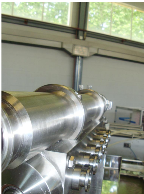
Figura 85. Conjunto sistema de alimentación.
