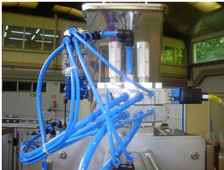
Figura 123. Entramado de tubos de aire comprimido.
