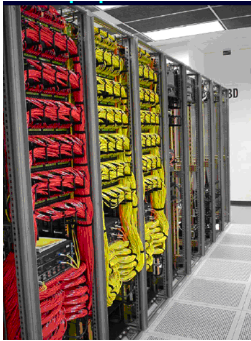
Figura 47 Visión del cableado en un rack [49]
