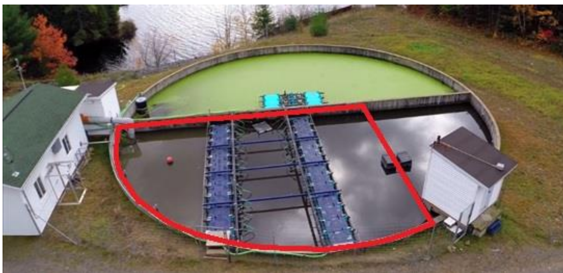
Figure 15 Étang aéré de Grandes-Piles (Qc) avec le système KAMAK MC
