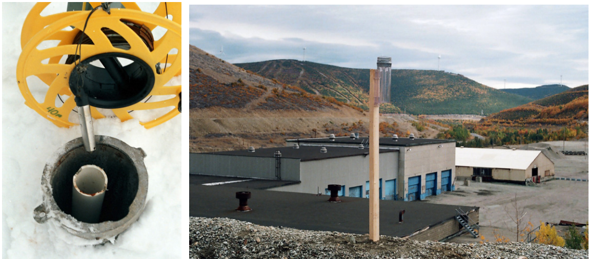
Photo 16 et 17. Équipements installés lors des travaux : enregistreur de données (gauche) et pluviomètre (droite).
