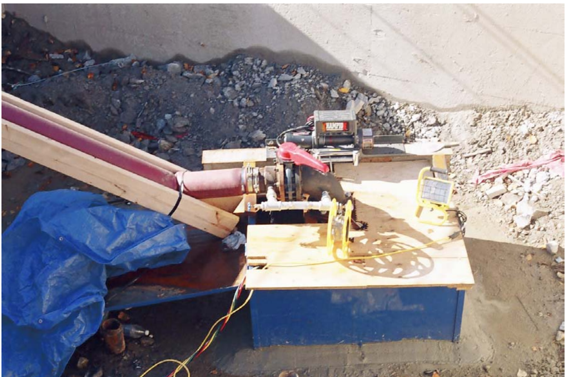
Photo 10. Installations de surface au puits 1100 lors de l'essai de pompage.
