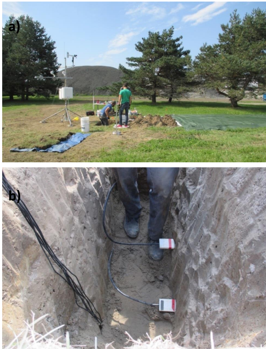
Figure 10. Tranchée d'installation des sondes dans la zone non saturée. a) Creusée de la tranchée et répartition du sol sur une bâche. b) Installation des sondes dans la tranchée.
