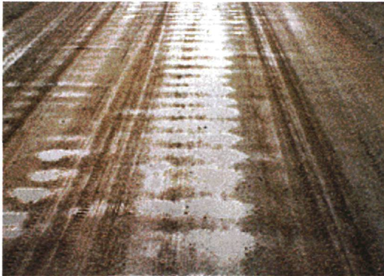
Figure 2.1: Présence de planches à laver sur une route non revêtue (source : Skorseth et Salim (2000)).
