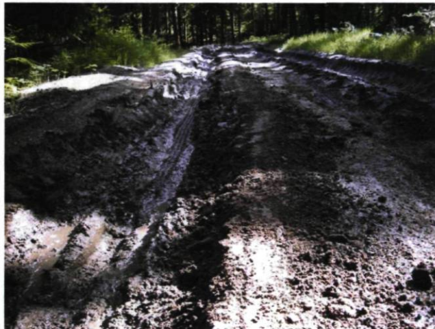
Figure 2.2 : Présence d'ornières sur une route non revêtue due au passage répétitif de véhicules et à la mauvaise qualité de la surface de roulement (source : http://arnaud.meunier.chez-alice.fr ).
