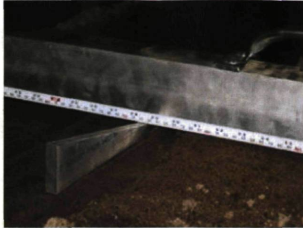
Figure 4.9 : Règle à ornière et coin biseauté servant à mesurer la profondeur des défauts de la route (il est ici possible de voir la présence d'une ornière).
