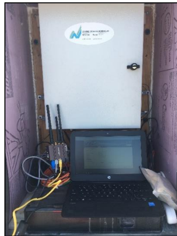
Figure 47. Vue du boîtier de la station-GN (antenne LTE à l'intérieur du boîtier lors des tests)
