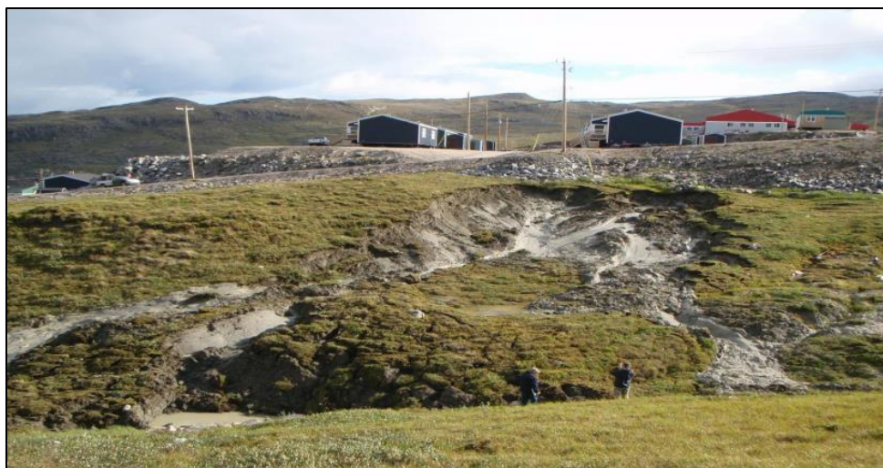
Figure 3. Glissement de terrain en bordure des infrastructures, et travaux de stabilisation en août 2010 [21]
