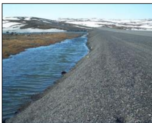
Figure 2. Tassements en bordure des remblais de l'infrastructure à Salluit [21]
