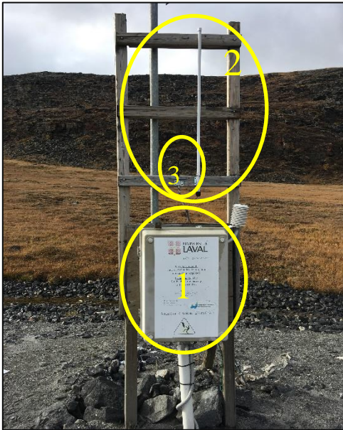
Figure 26. Vue de la ST-A. 1. Coffret fermé contenant le système d'acquisition et le modem LTE. 2. Antenne Wi-Fi. 3. Antenne LTE
