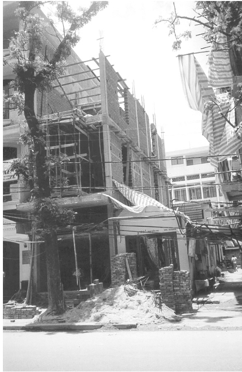
Figure 1.7 : Le 106 Nguyen Du en construction à Hanoi (photo par Jonathan Boucher et Dany Blackburn, 2002)
