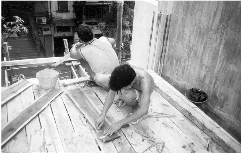
Figure 1.18 : Utilisation du bois pour la confection des coffrages (photo par Jonathan Boucher et Dany Blackburn, 2002)
