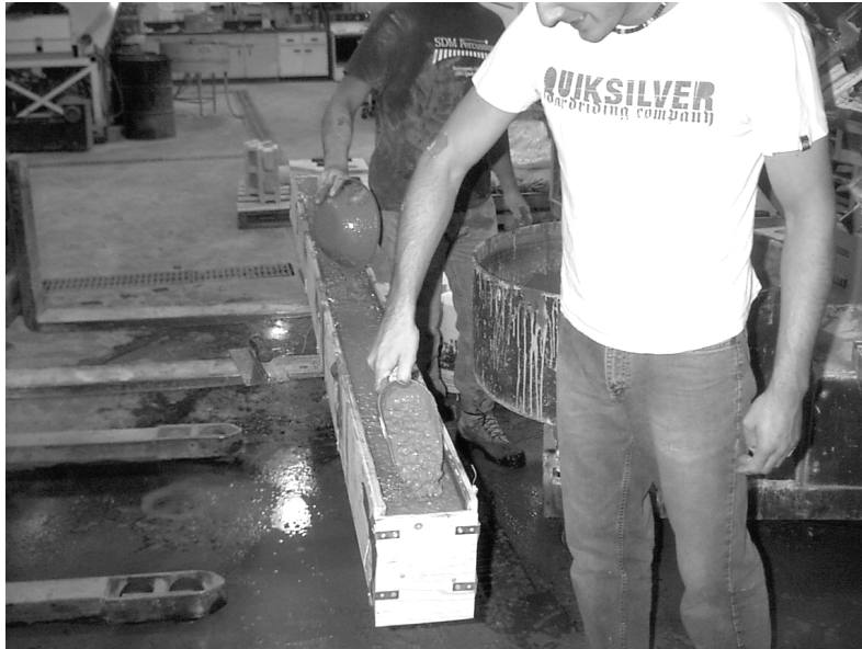
Figure 3.27 : Coulée du béton dans le coffrage (photo par Jonathan Boucher et Dany Blackburn, 2004)
