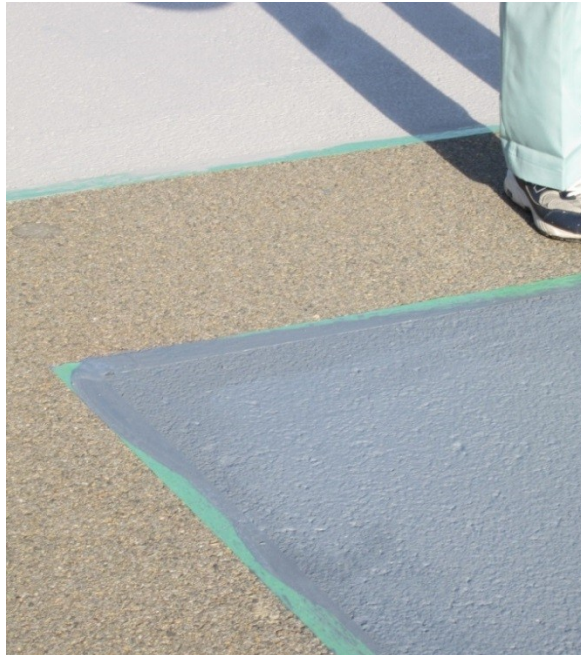
Figure A.27: Texture de la section de Perfect Cool AP (en haut – section E) et de Perfect Cool A (en bas – section D) posé sur enrobé bitumineux
