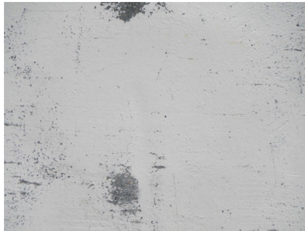
Figure 6.4: Surface de l'enduit de Lafrentz en mai 2013
