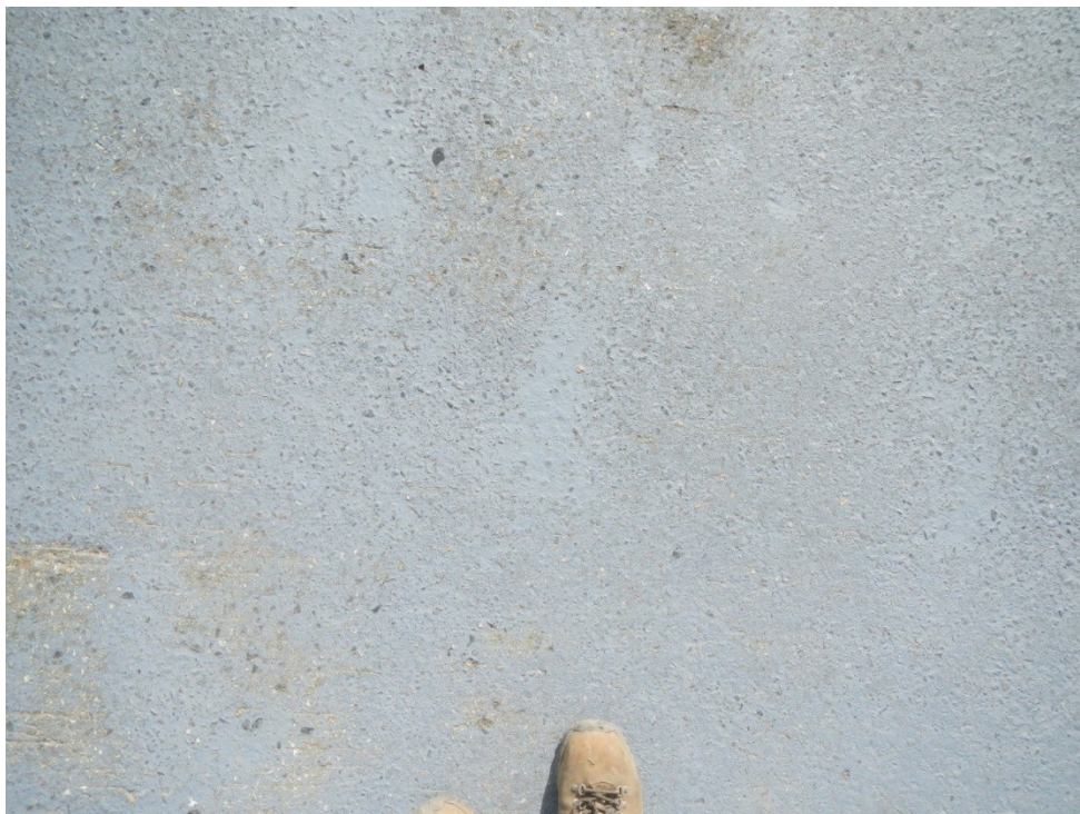
Figure 6.32 : État de la surface de PerfectCool A en mai 2013
