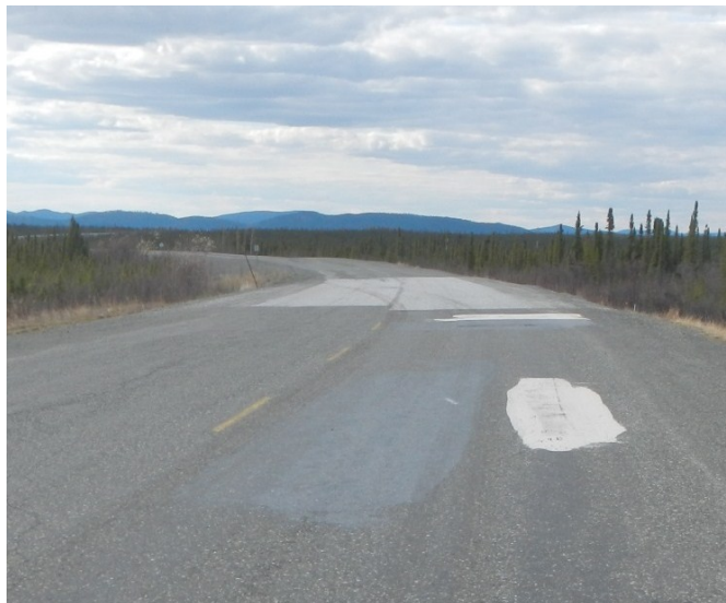
Figure 3.5: Enduit Perfect Cool A à gauche et l'enduit de Lafrentz à droite; la section instrumentée en arrière-plan
