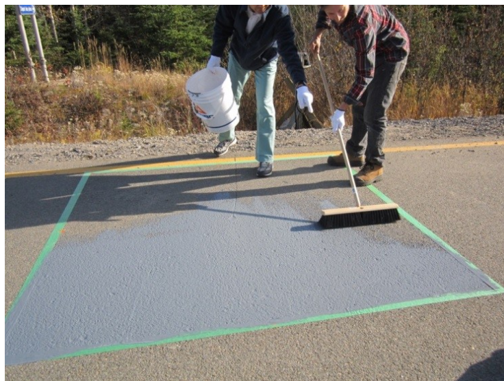
Figure A.22: Pose de la première couche de l'enduit Perfect Cool A sur enrobé bitumineux à l'aide d'un balai (section D)
