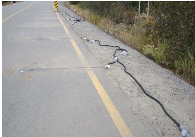
Figure A.10: Section d'enrobé bitumineux suite à la pose des sondes et des thermistances avant l'enfouissement des câbles
