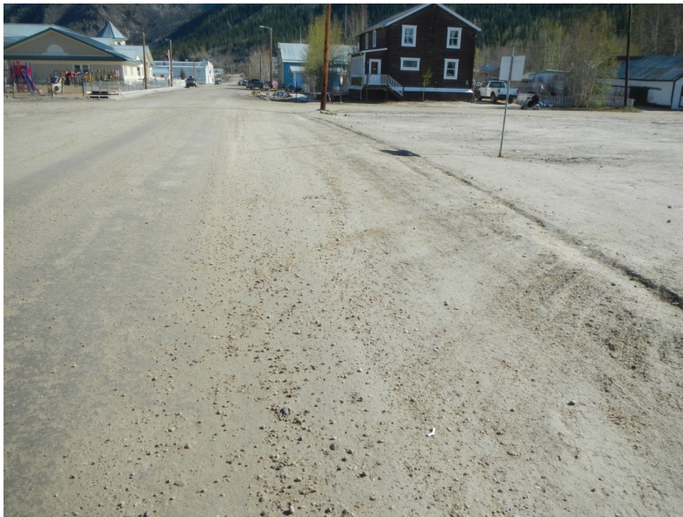
Figure A.32: Emplacement 1, surface de gravier au coin de la Fifth Avenue et de la Princess Street
