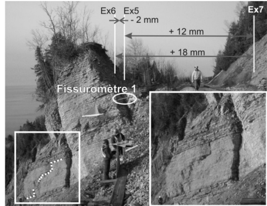
Figure 6. Formes en échelons (traits pointillés). Le fissuromètre 1 se referme depuis son installation. Les flèches indiquent les déplacements mesurés sur les tiges extensométriques, EX5, 6 et 7 (vue vers l'ouest).
