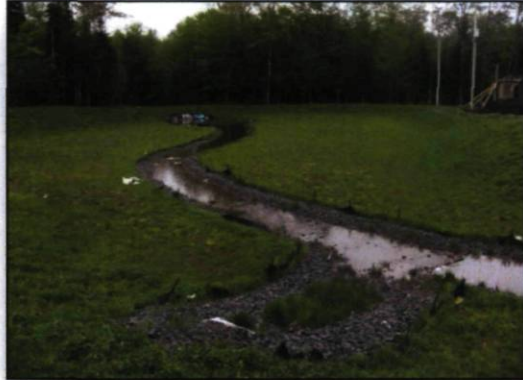
Figure 4 – Photo d'un bassin d'orage
