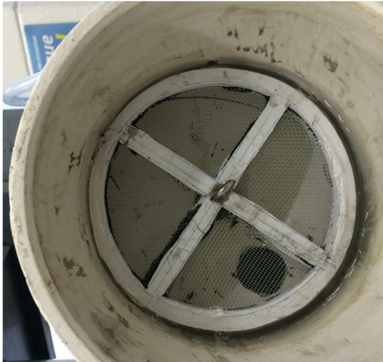
Figure A. 7 : Tamis installé sur le dessus du biofiltre pour éviter les pertes du milieu filtrant pendant les rétro-lavages.
