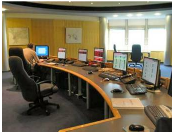
Figure 16 – Le Centre de télégestion du Groupe des Eaux de Marseille
