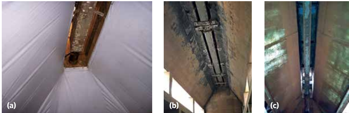
Figura 12 – Separadores trifásicos com canaleta interna de coleta de espuma: a) STF confeccionado em concreto e lona, com canaleta em alumínio; b) STF confeccionado em concreto, com canaleta em PRFV; e c) STF confeccionado em PRFV, com canaleta em PRFV.
