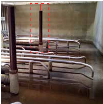
Figura 4 – Tubulação de descarte de lodo posicionada muito próxima do defletor de gases, em desacordo com o projeto.
