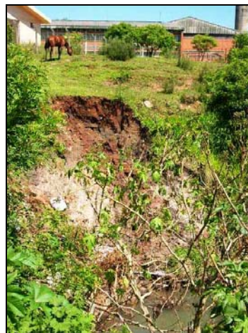
Figura 10 – Desmoronamento das margens do córrego.
