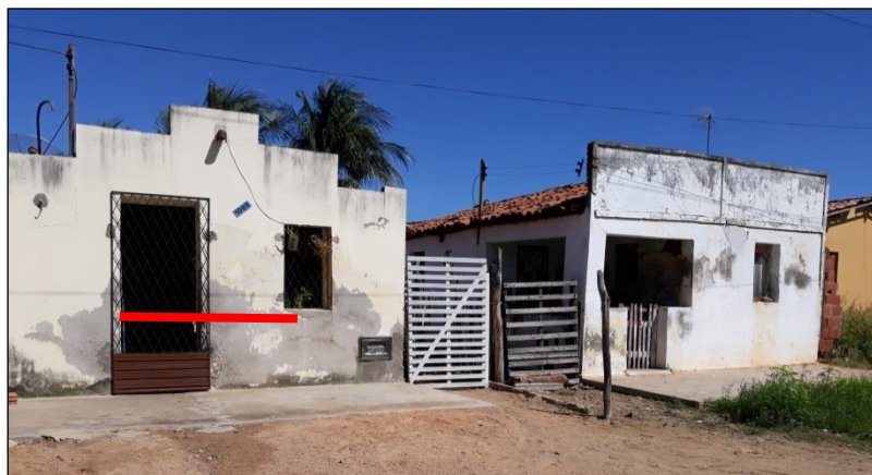
Figura 5: Altura atingida pela água na inundação de 1974, sinalizada pela linha vermelha. Fonte: Arquivo pessoal, 27 de maio de 2018
