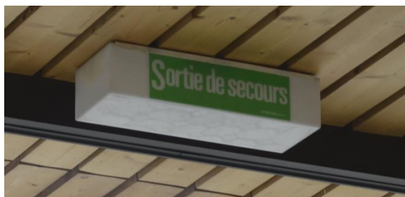
Figure 11- Luminaire sortie de secours
