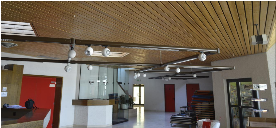
Figure 20- Luminaire hall d'entrée
