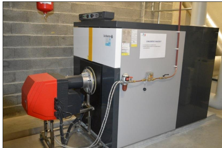
Figure 29- Chaudière à mazout, CAD de Riddes
