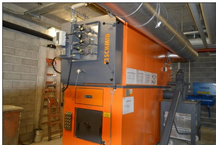
Figure 28- Chaudière à bois, CAD de Riddes
