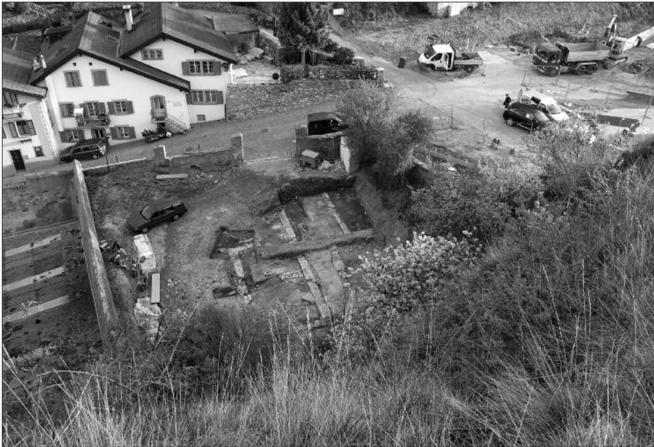
Fig. 29 – Sion, Parking de l'Ancien Pénitencier, fouilles 2010. Vue générale du site depuis la colline de Valère. Au centre, le couloir du corps de bâtiment barrant le vallon entre les collines de Valère et Tourbillon.
