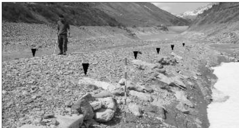
Fig. 10 – Bourg-Saint-Pierre, Barrage des Toules. La chaussée utilisée entre 1893 et 1963, vue depuis la Cantine vers l'aval. Les bouteroues jalonnant jadis le tracé (indiquées par les flèches) se sont déversées vers l'extérieur sous l'effet des fluctuations du niveau du barrage. A cet endroit, la route présente un profil bombé et forme une berme surélevée par rapport au terrain environnant.
