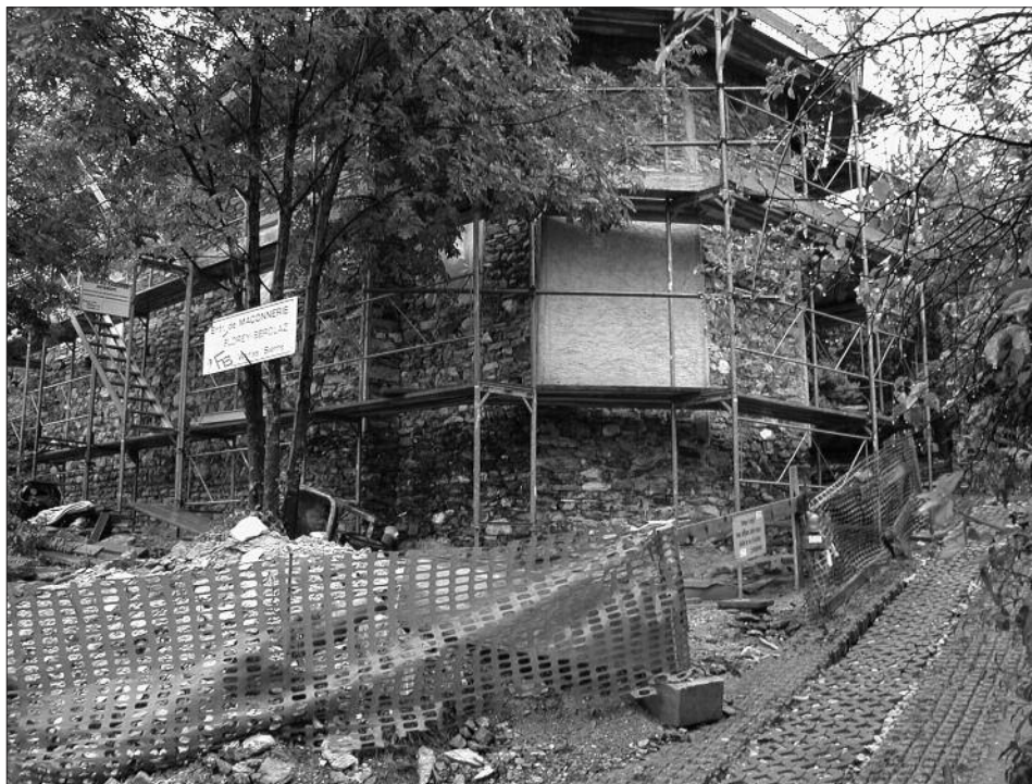
Fig. 1 – La chapelle de Muzot vue depuis le sud-est après décrépiage des façades.
