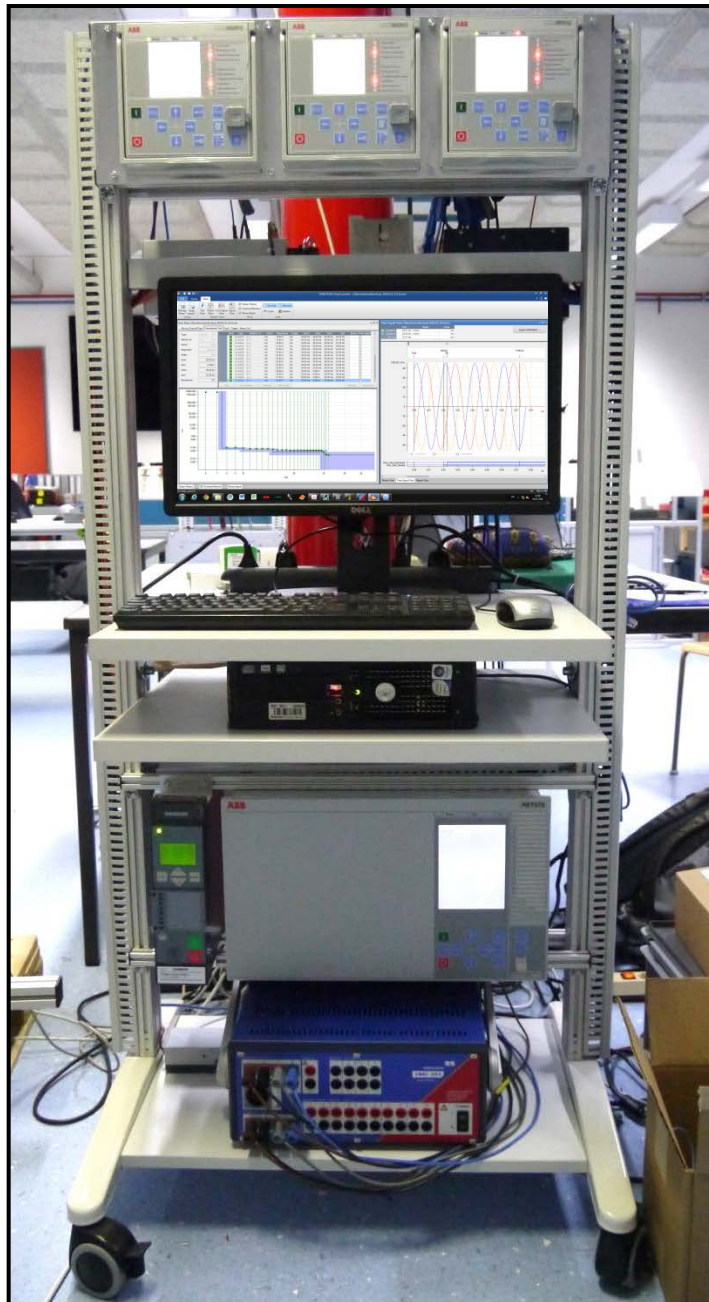
Abbildung 20 : Aufbau der Testbank im GridLab
