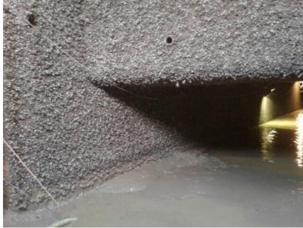
Figuur 3.15: Aanhechting van quaggamosselen bij het boezemgemaal Gouda (© Foto: HHR uit Van der Kamp & Penning, 2015).
