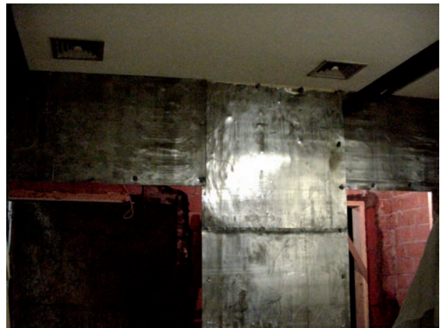
Figura 2: Paredes recubiertas de plomo en una sala de RX.
