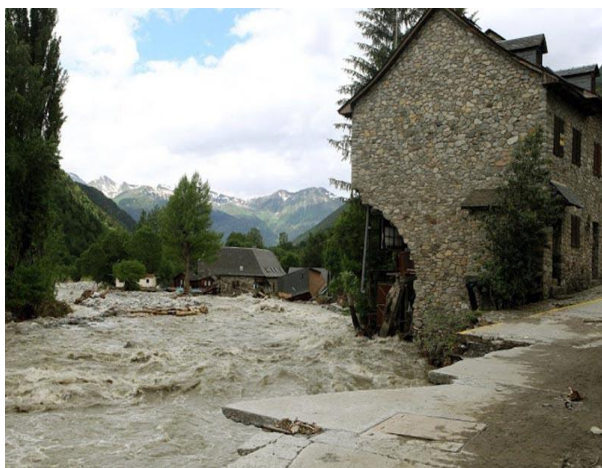
Figura 11. Socavación fluvial en un edificio del margen derecho a la salida de Arties (IGC, 20/07/2013).
