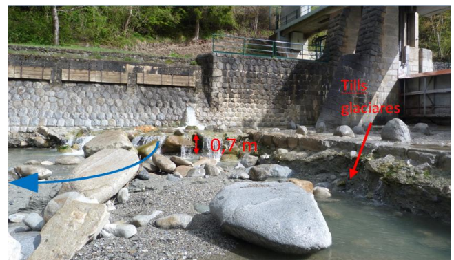
Figura 15. Erosión fluvial a la salida de la presa situada aguas arriba de Arties.
