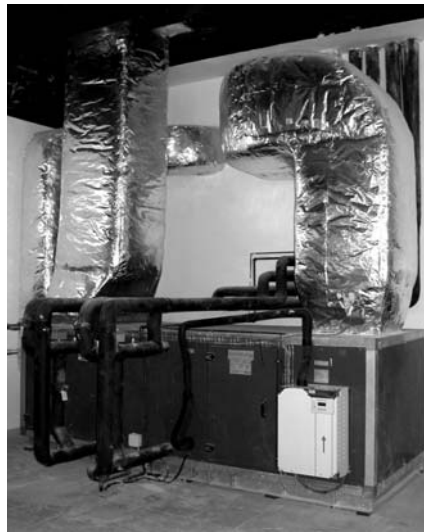
Figura 23. Sala del climatizador modular 1.
