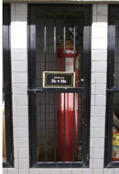
Figura 41. Armazenamento adequado do gás.
