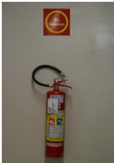
Figura 32. Extintor tipo “Pó químico”.
