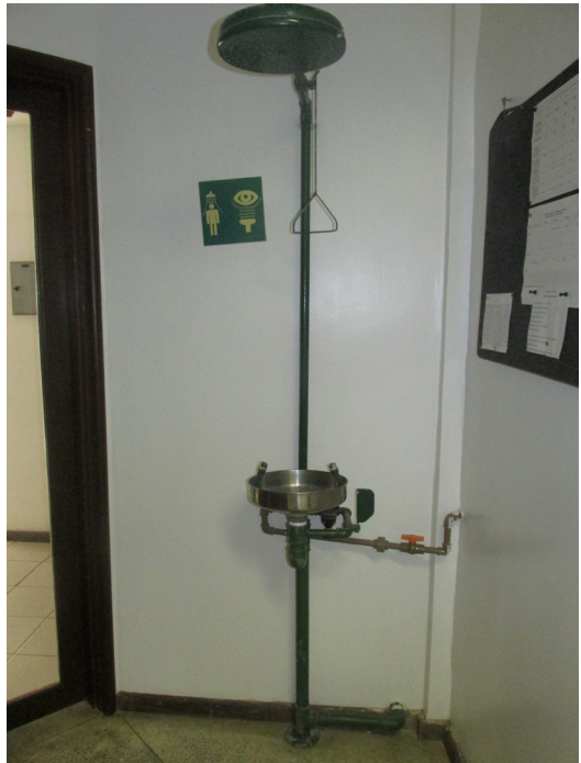
Figura 37. Chuveiro de emergência (A). Lava-olhos (B).
