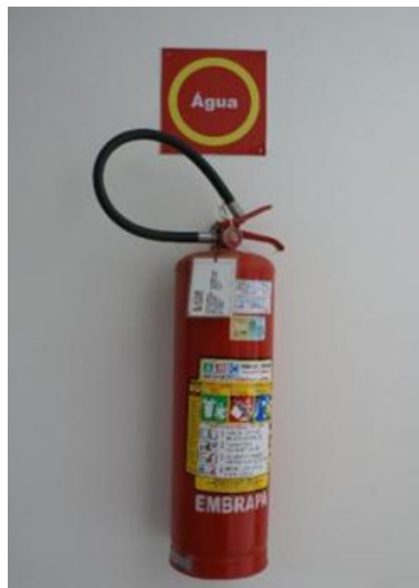
Figura 34. Extintor tipo “Água pressurizada”.
