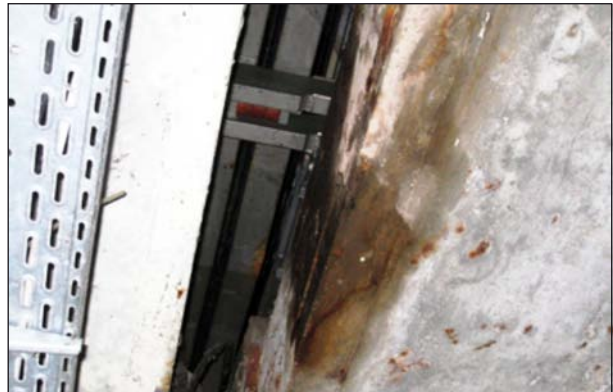
Bild 3.3: Vorderseite des nördlichen Widerlagers. Feuchte Stellen und Rostflecken auf der Betonfläche sind klar erkennbar (aus Bauwerksbuch)
