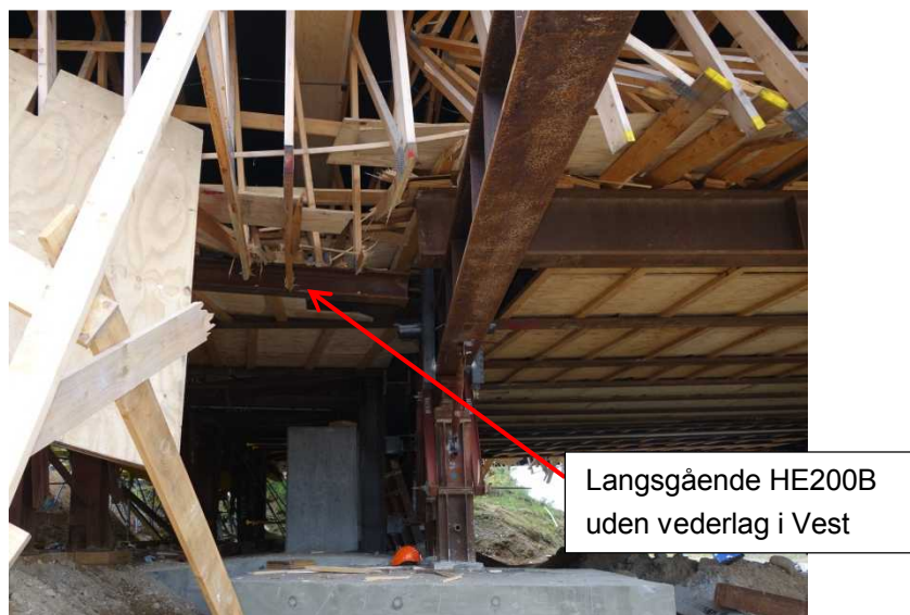
Figur 28 Foto fra nord ved girder 2.
