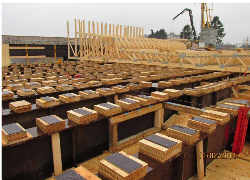
Figur 46. Foto fra montagen af træspær. Opklodsninger for træspær er udlagt foran de allerede monterede spær på de langsgående stålbjælker.
