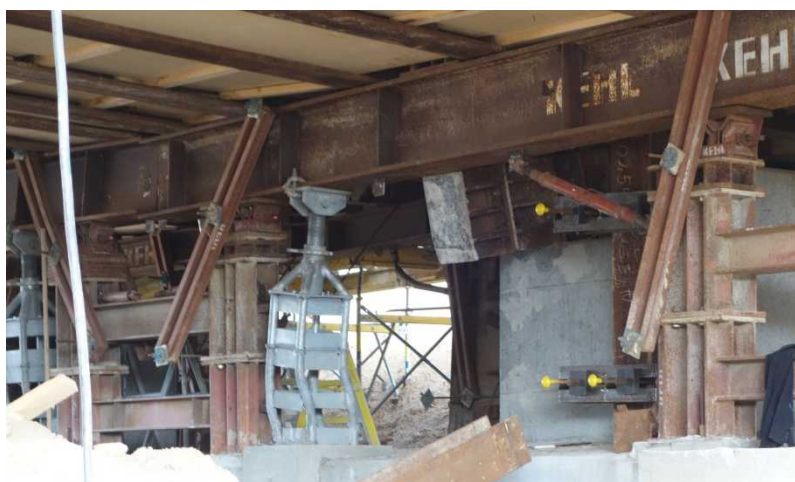
Figur 32 Lejelinje ved girder 2 set fra Syd. Svært deformerede H45 søjler, der er knækket ud som følge af overbelastning
