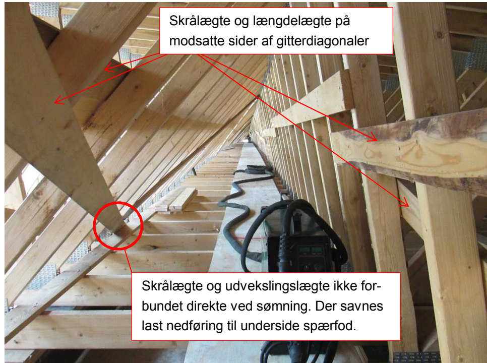
Figur 42. Ukorrekt udførte løsninger med excentriciteter og mangler.
