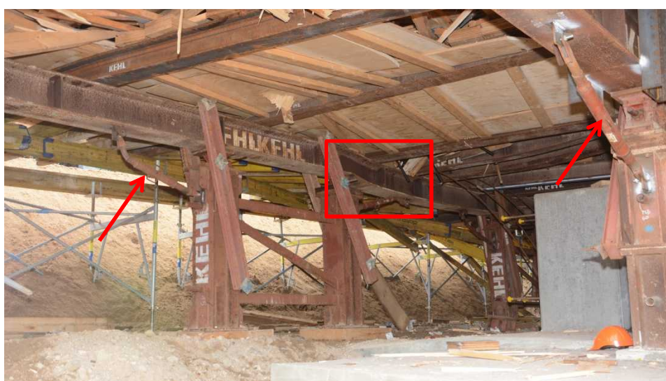
Figur 29 Foto af plastisk deformeret girder 1 set fra nord. Plastisk deformation af tværdrager på grund af overbelastning markeret med rød ramme. Bemærk også deformationerne i Z+D struts (markeret med pile).
