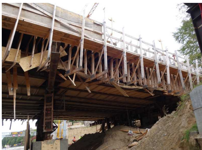
Figur 12. Foto af fag mellem girder 2 og 3 set fra syd
