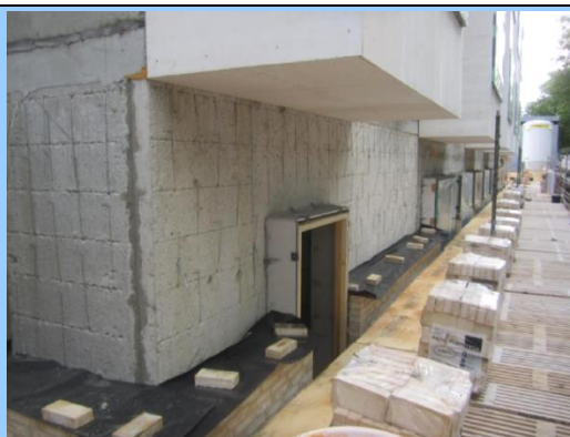
BILLEDE 5: OPMURING UNDER UDHÆNG (FOTO: BYGGERIETS ARBEJDSMILJØBUS)
