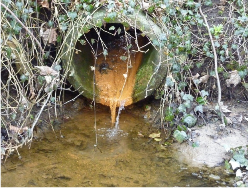
FIGUR 5.1 DRÆNRØR TIL BRÆNDHOLDTAFLØBET VED LILLESKOVVEJ LOSSEPLADS. DER VAR IKKE OPLYSNINGER OM DRÆN I ORBICONS ARKIVER, SÅ KUN VED EN BESIGTIGELSE BLEV DE TRE DRÆNRØR LOKALISERET.
