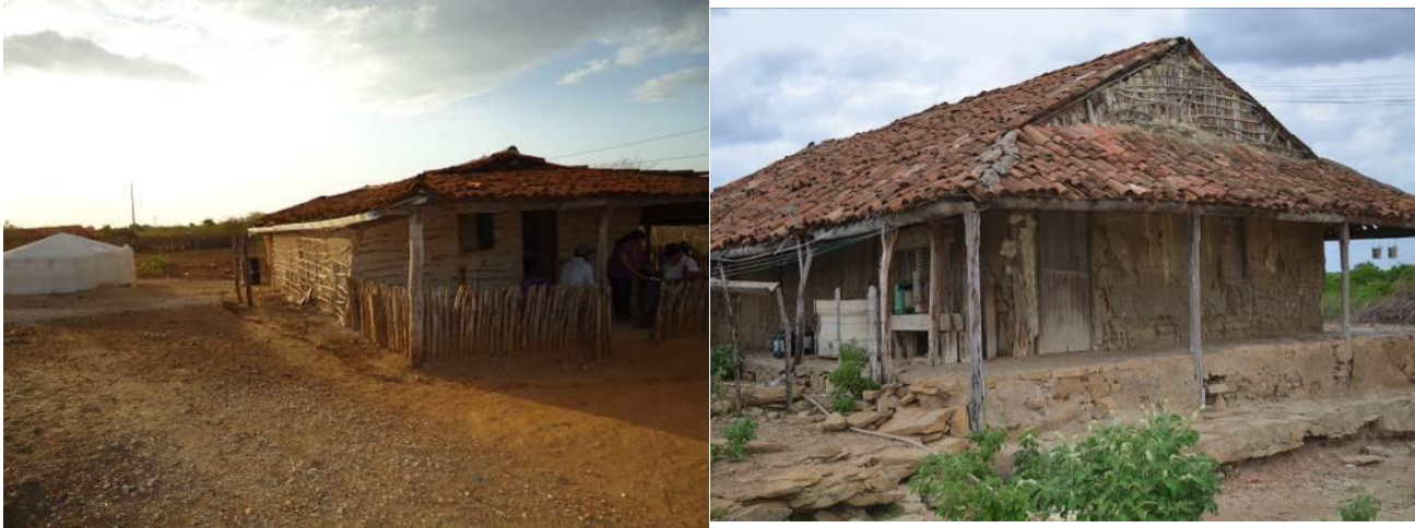
Figura 6. Estrutura das residências dos agricultores iliares, comunidade Olho D'Água Velho, Mossoró-RN, beneficiados pela Chamada Pública SAF/ATER nº 010/2012. Fonte: Acervo do autor.
