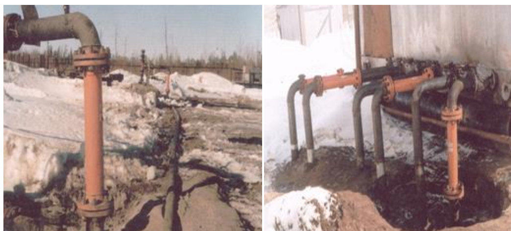
Рисунок 2.5– Магнитные камеры на устье и на входе в АГЗУ
