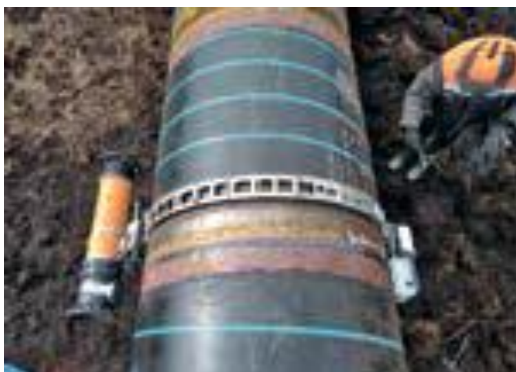
Рисунок 1.2 – Комплекс «УНИСКАН МТ». Контроль по схеме «Фронтально» (через две стенки) на строительстве МГ «Сила Сибири», этап 2.7, участок 1636–1817,9 км, май 2018 г. Труба 1420 × 21,7 мм, время монтажа/демонтажа комплекса 5-7 мин, время контроля сварного соединения 21 мин
