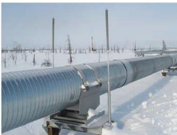
Нефтепровод «Ванкор–Пурпе», участок надземной прокладки
