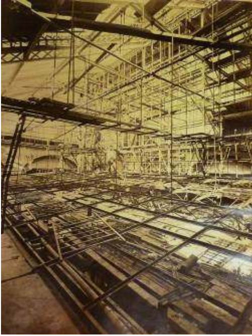
Louis Émile Durandelle, Vue des travaux de la verrière du Comptoir d'escompte de la ville de Paris , s. d., tirage sur papier albuminé, bibliothèque des Arts décoratifs, PHO 30.24.
