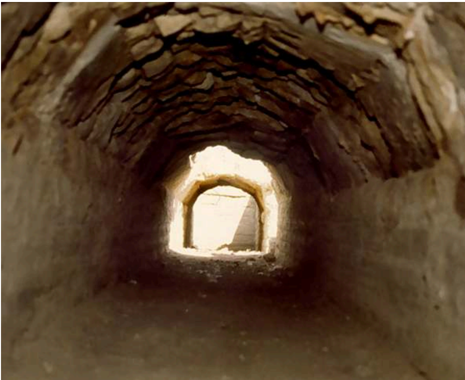
Fig. n°5 : Égout de la pièce froide avec empreintes des planches du cintre encore visibles
