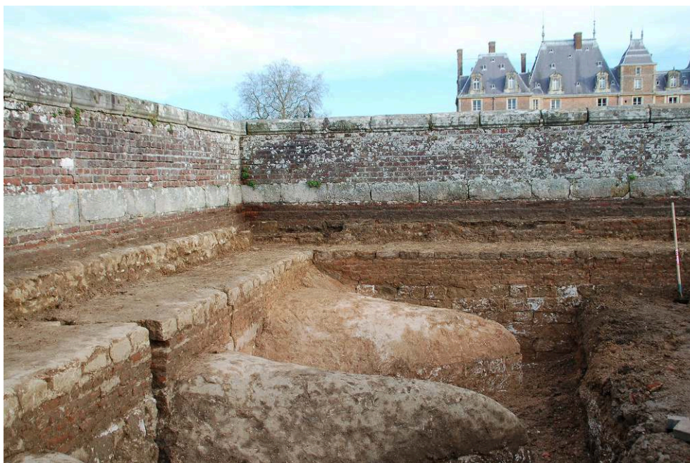
Fig. 1 – Vue générale du mur du bastion, de la fondation du parapet du jardin à la française et des désordres structurels
