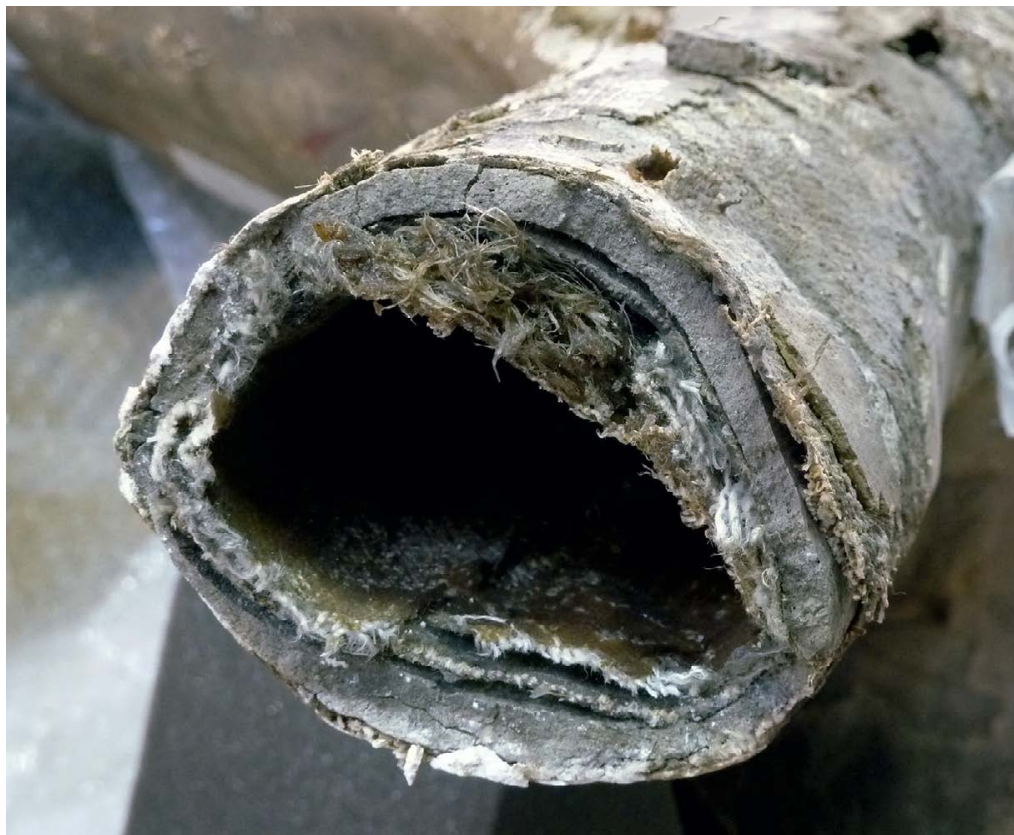
Fig. 3. Vue de l'organisation des matériaux au niveau de la cassure du bras droit. © H. Gruau.
