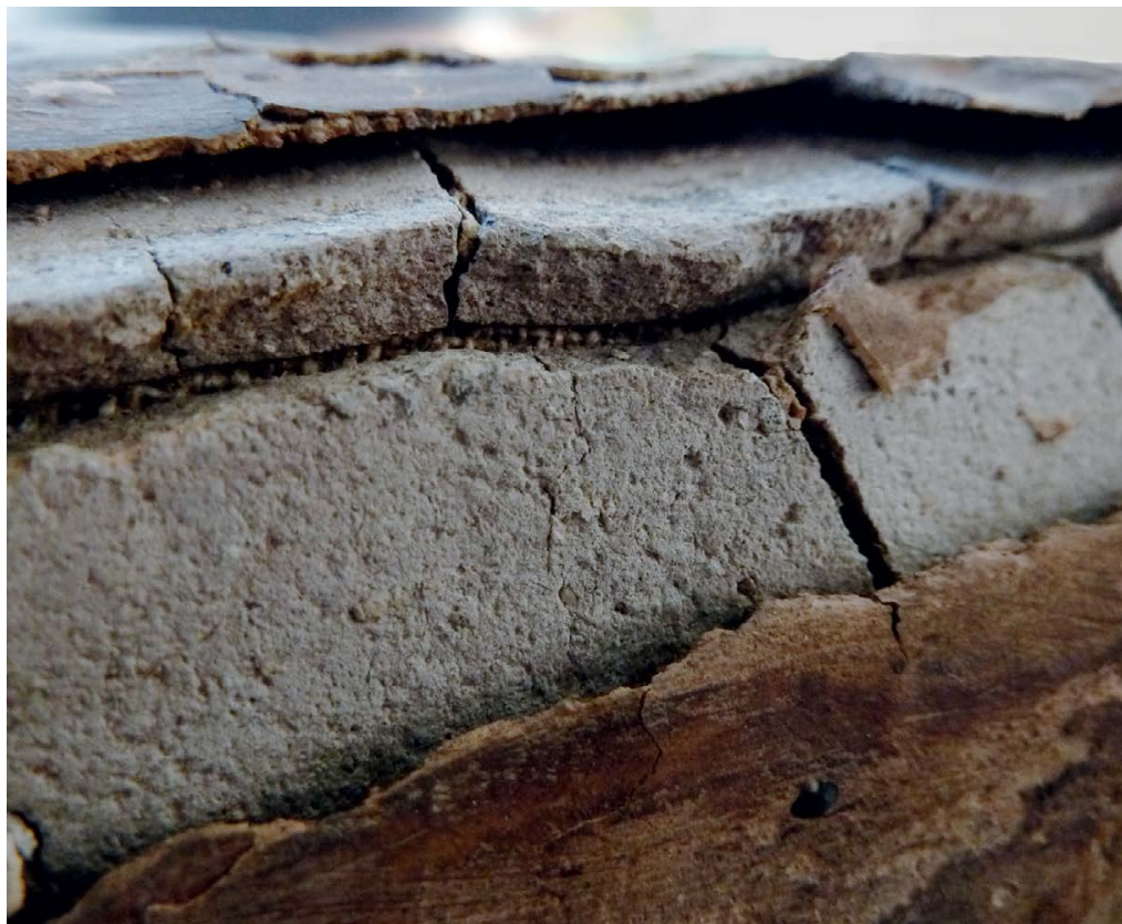
Fig. 4. Vue de l'état de fragmentation du mortier sur l'arrière de la jambe. © H. Gruau.
