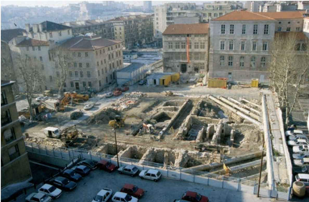
Fig. 6. Vue d'ensemble du chantier « César 1 » en 1996. Au fond, le pavillon Bargemon, la Maison Diamantée et le pavillon Daviel (cl. A. Arbion/Inrap).
