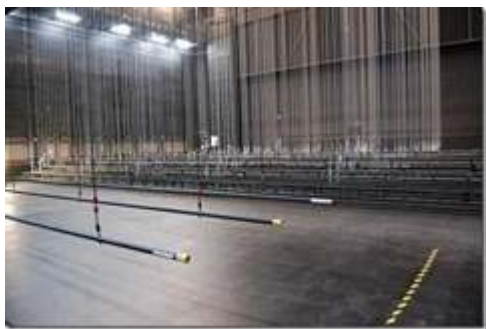
Figure 6. Les perches : des déformations importantes sont relevées
