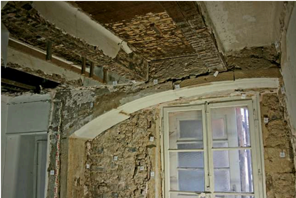
Fig. 1 – Rez-de-chaussée, espace 11, mur M9, sondage 6 : vue rapprochée de l'arcade ARC 1089 et plafond de la pièce
