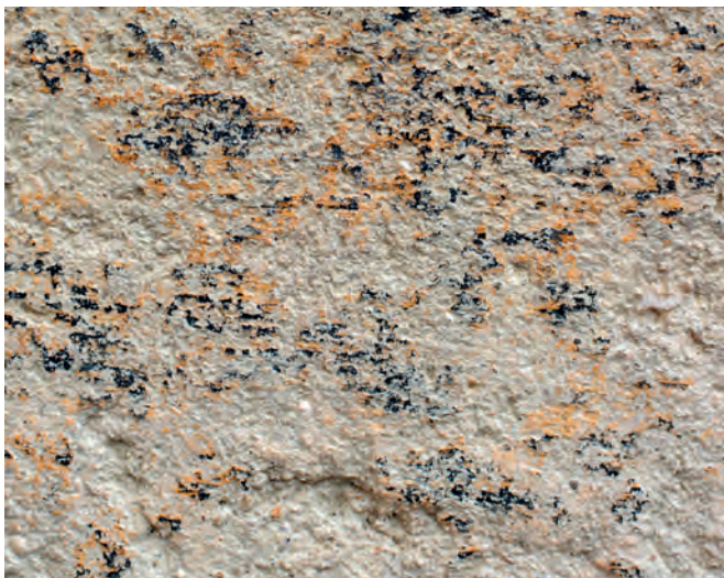
Fig. 298. Détail de la couche picturale noire appliquée sur une sous-couche jaune au niveau de la plinthe (cliché L. Lemoigne).
