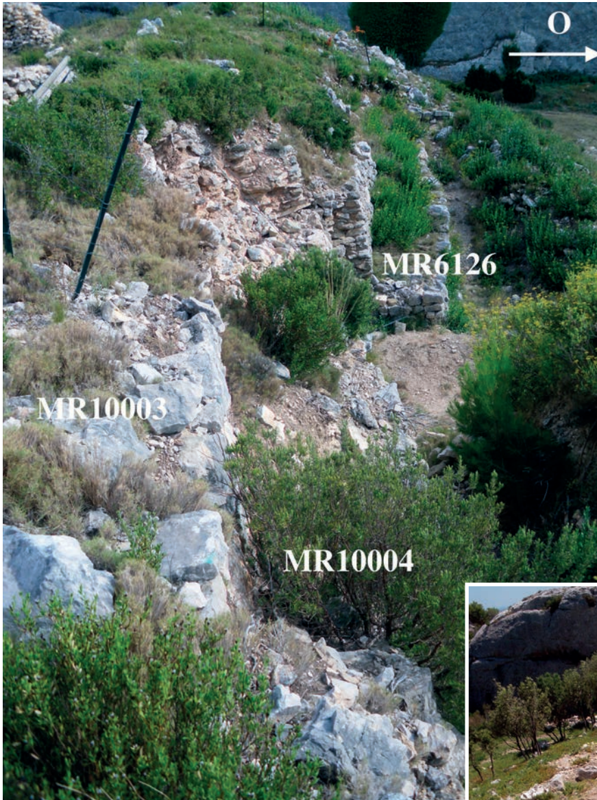
Fig. 70. Parements successifs du rempart R1 visibles de part et d'autre de la zone Z06. Vue nord-sud.
