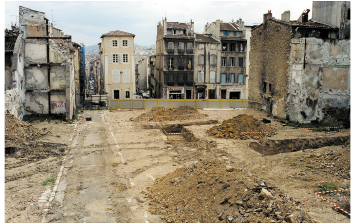
Fig. 2. Les sondages de la campagne de diagnostics après démolition des derniers immeubles de l'îlot (photo Inrap).
