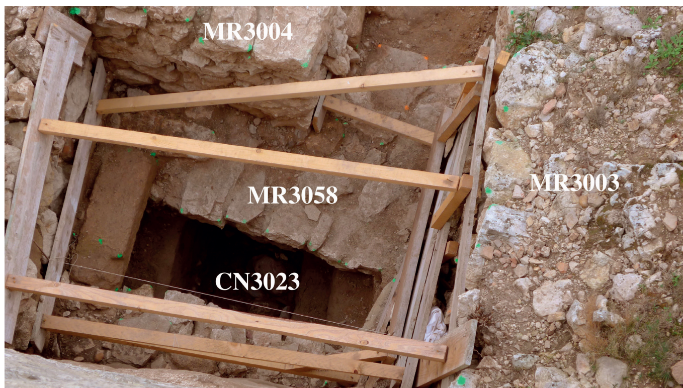
Fig. 99. L'égout CN3023 de la salle 2C entre le pied de la falaise et le massif MR3058. Après être passé sous le mur MR3003 de la tour (à droite), il s'engage (à gauche) sous le mur MR3005.
