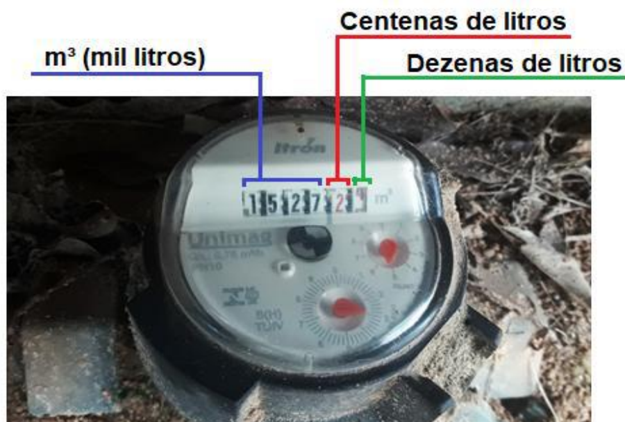
Figura 3. Foto do hidrômetro da residência antes das alterações no registro (Batista, 2019)
